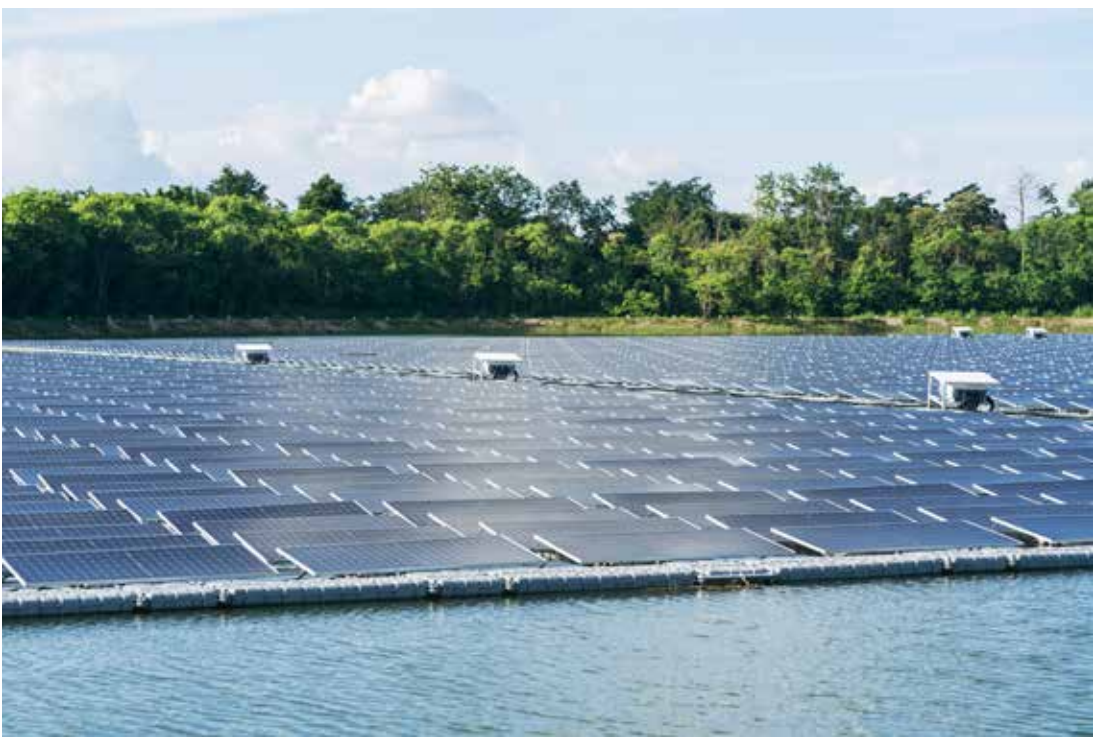
Imagem ilustrativa de usina solar flutuante.
