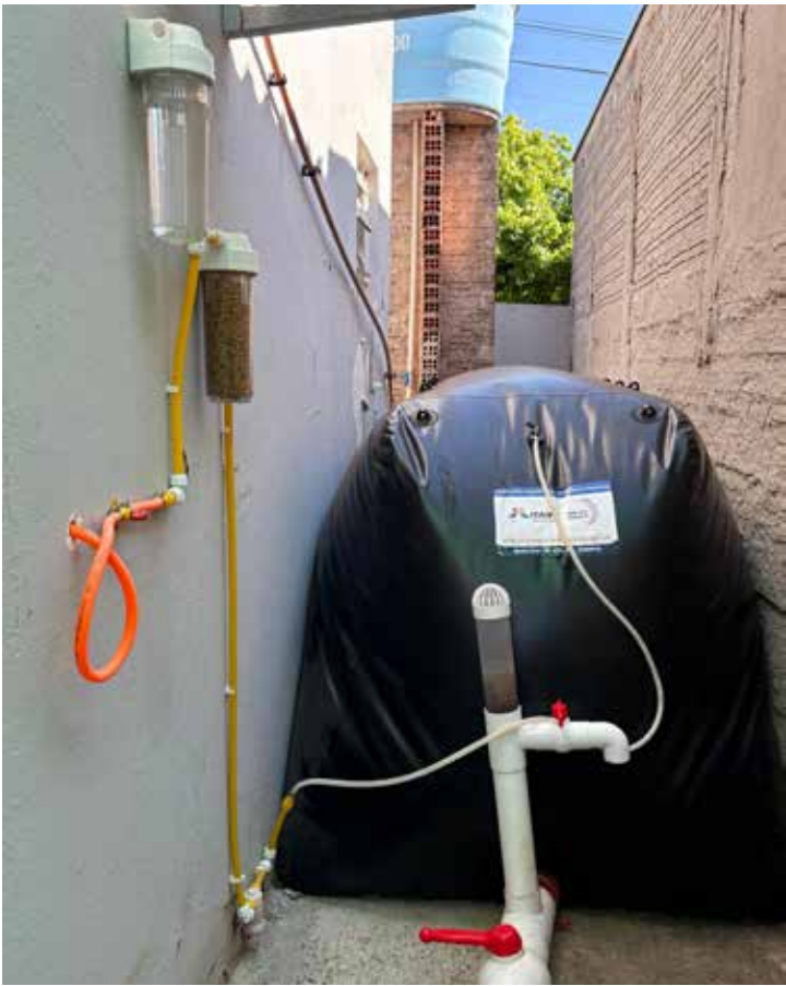
Biodigestor na Escola Vânia Maria Simão de Atalaia transforma restos de comida em gás sustentável e adubo, unindo economia, educação ambiental e agricultura local
